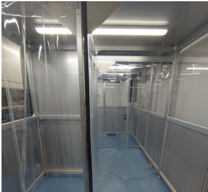
本棟2F クリーンブース
